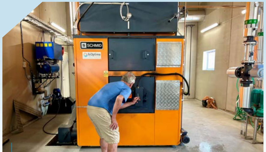
Mikael kikar in i flispannans förbränningskammare. Anläggningen är väldigt ren och doftar tydligt som en bastu.
